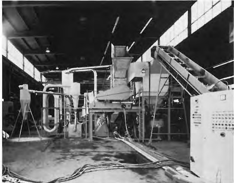
Bild 5.24 Kunststoff-Aufbereitungsanlage der Fa. Herbold
