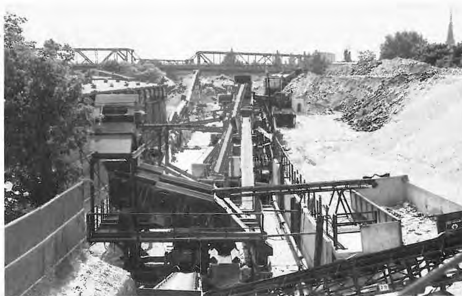
Bild 2.13. Gesamtansicht der Bauschuttaufbereitungs- anlage, Firma Hafemeister, Berlin
